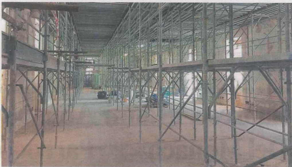
Il cantiere nel monastero di San Basilio che diventerà tra meno di un anno Centro congressi dell'Università
